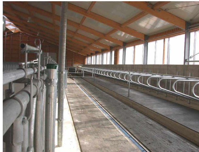
Die Jungviehseite wurde mit Hochboxen ausgestattet.
